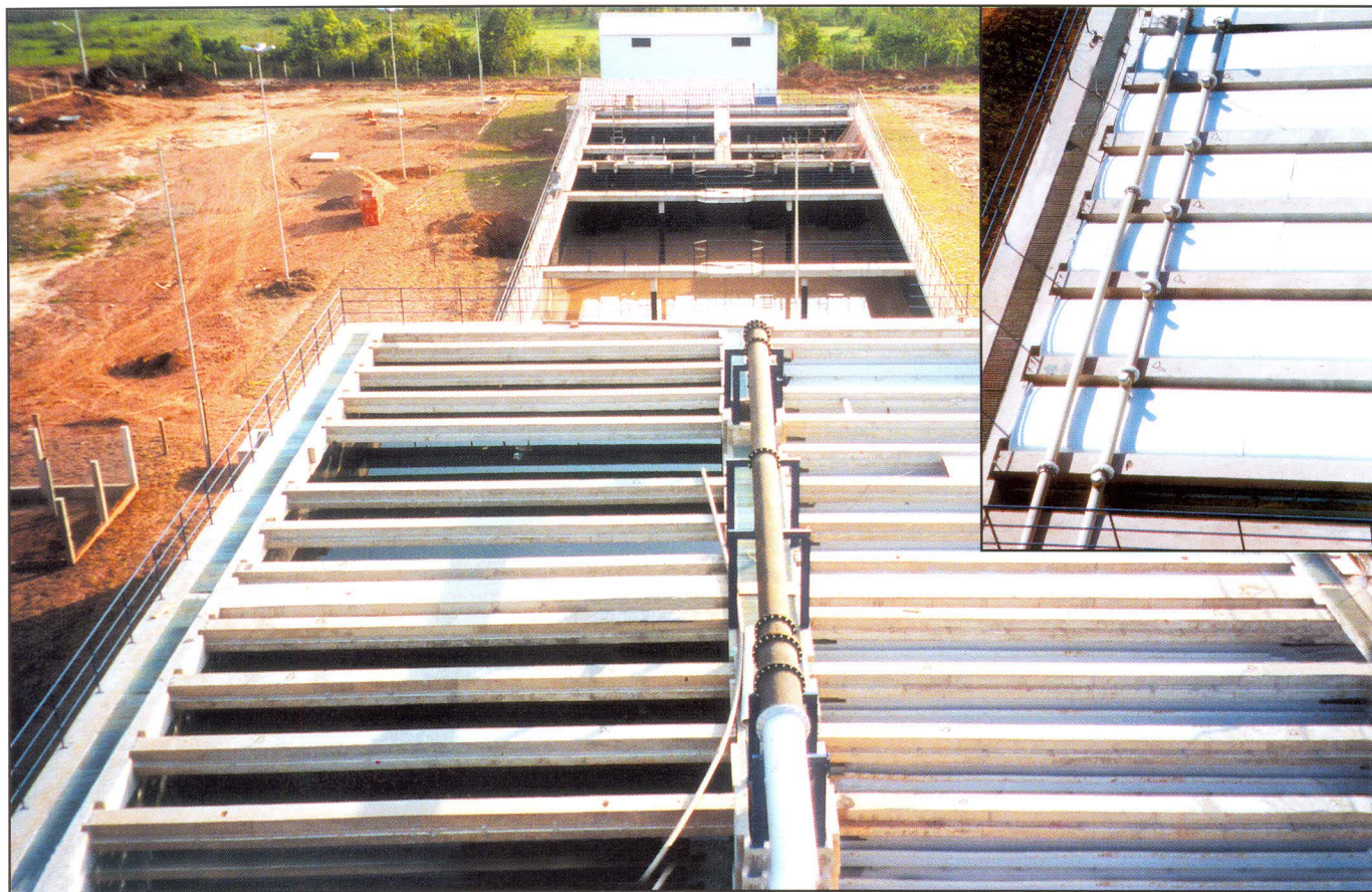
Reatores anaeróbicos e aeróbico, no detalhe vista da cobertura com tubos para a coleta de gases.
